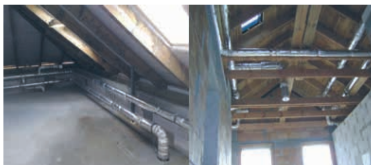
Instalacja wykonana w technologii kanałów sztywnych.
