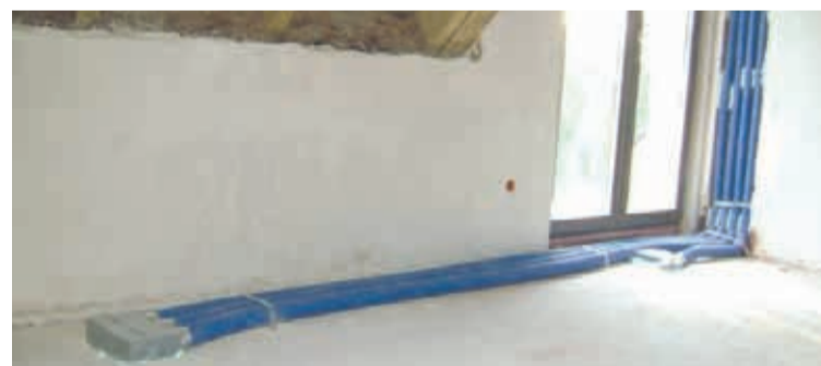
Instalacja wykonana w technologii Ventiflex.
